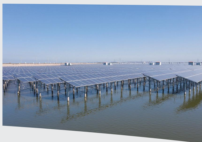
海上光伏电站
