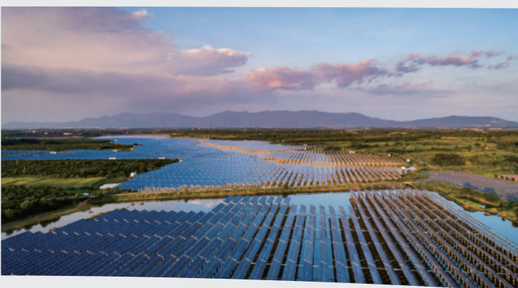
渔光互补光伏电站
